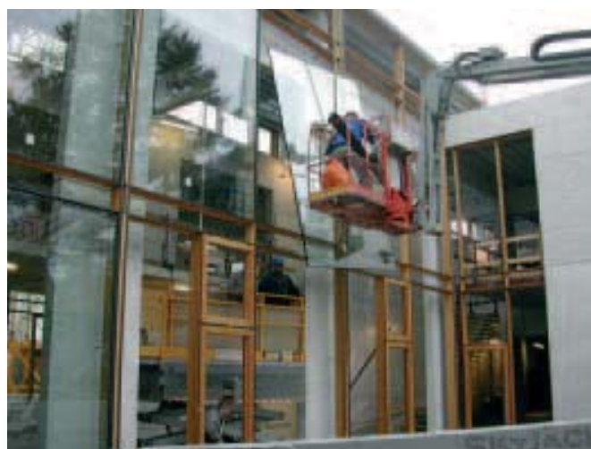
Monteringen af de store ruder i tegnestuen Cubo Arkitekter A/S's byggeri for Scion-DTU A/S strakte sig over fem måneder.
